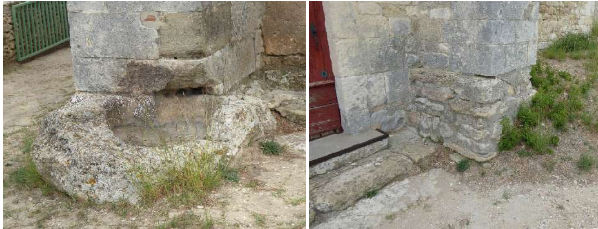
Fig 8. Soubassement de la chapelle en amont, façade Sud ©EQ
