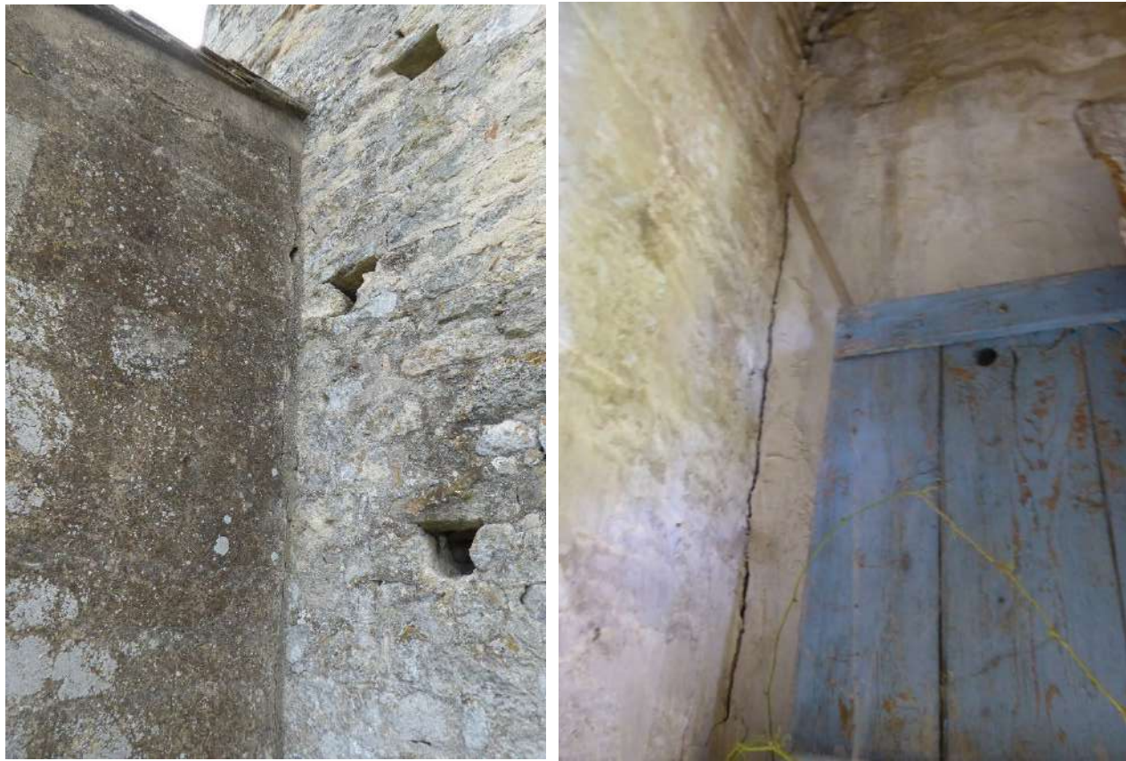
Fig 22. Sacristie, fissure traversante ©EQ
