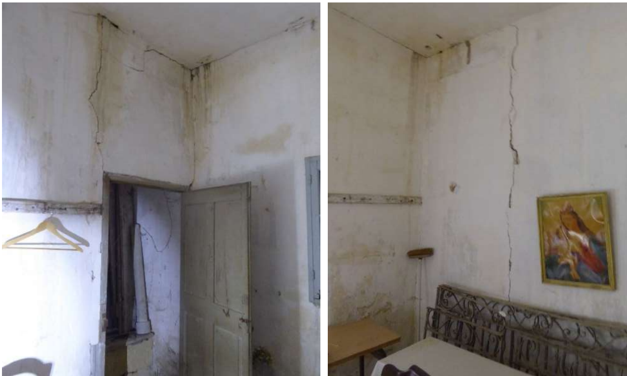
Fig 23. Pièce annexe, fissures traversantes ©EQ
