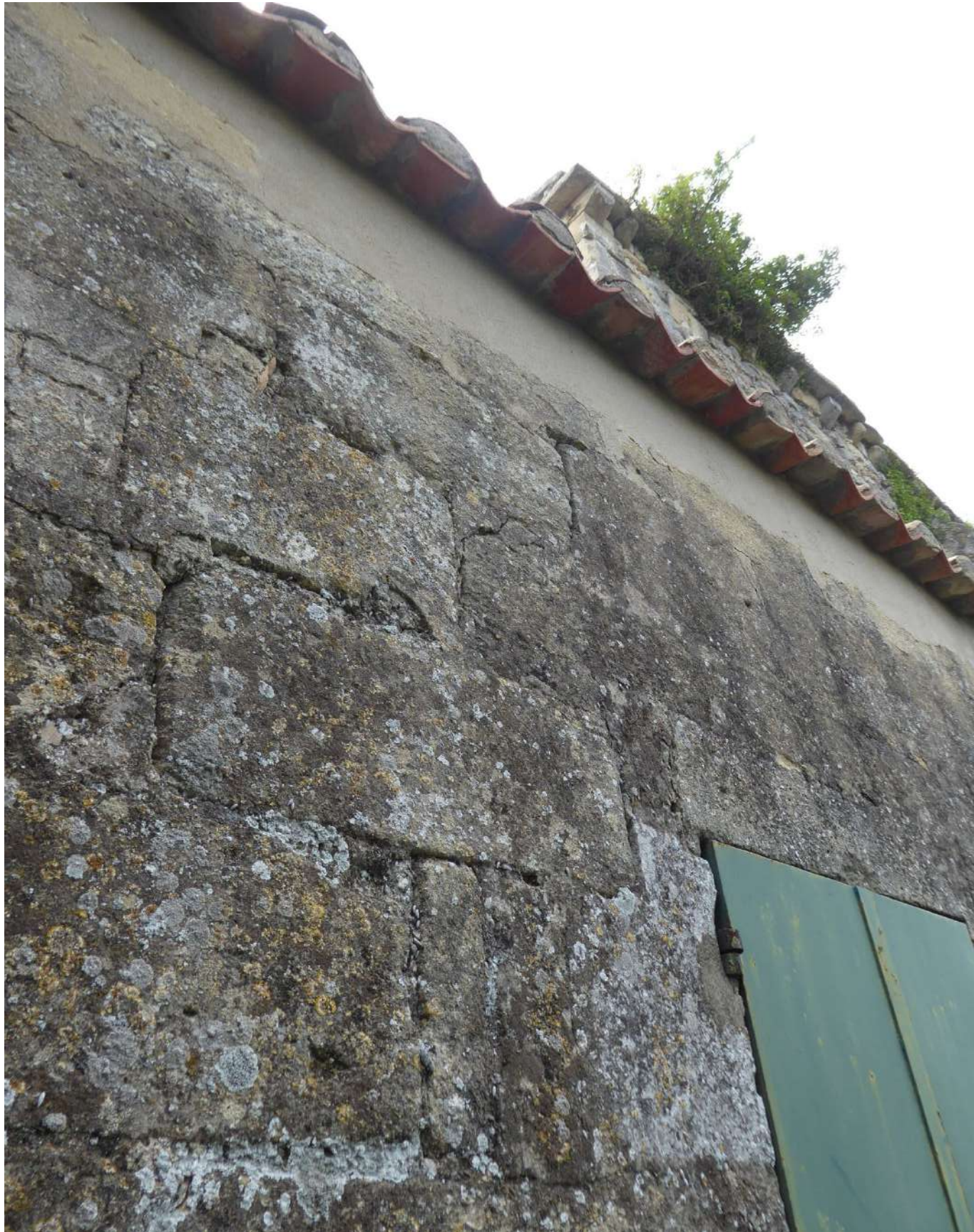
Fig 25. Sacristie, fissure diagonale ©EQ
