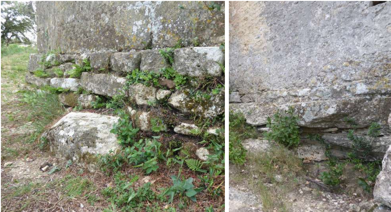
Fig 29. Déjointoiement des soubassements ©EQ
