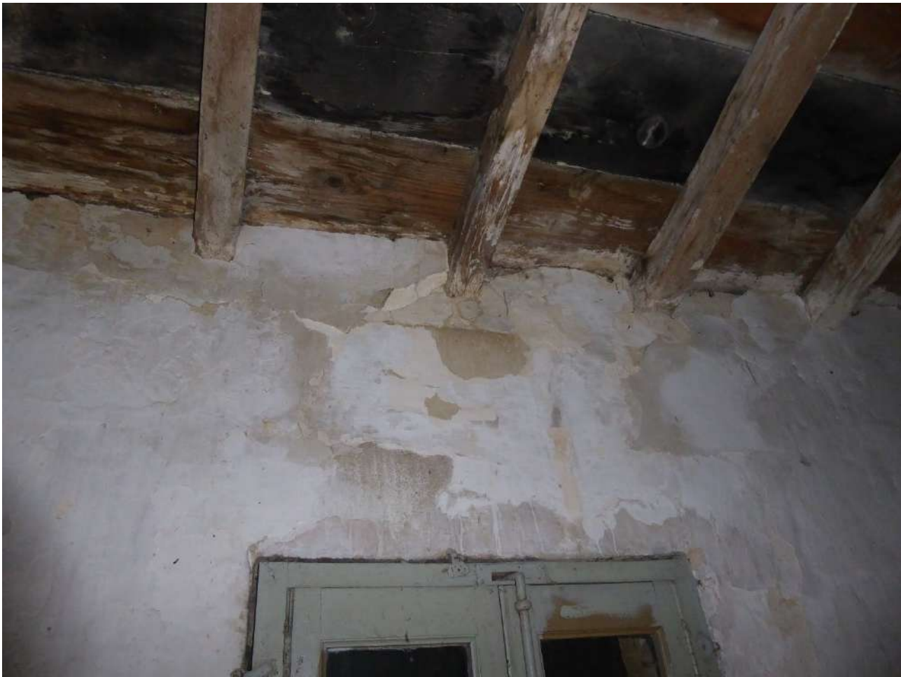
Fig 30. Piece annexe, humidité ©EQ
