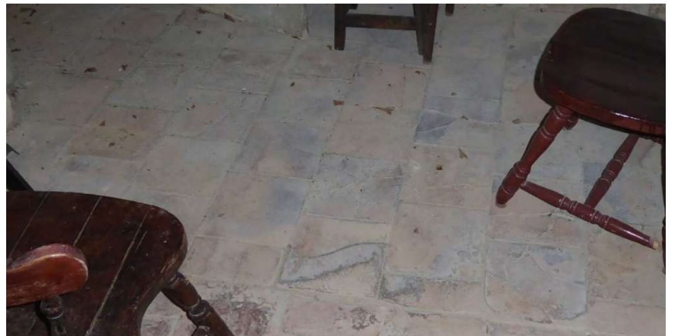
Fig 24. Sacristie, fissure de carrelage ©EQ
