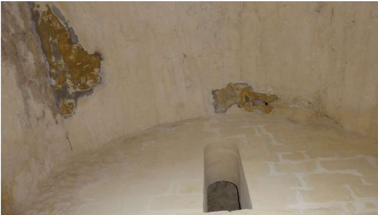
Fig 28. Nef de la Chapelle, infiltrations d'eau ©EQ
