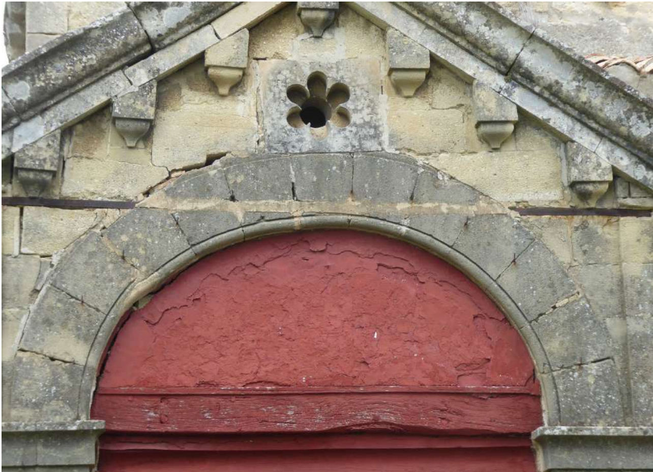
Fig 27. La chapelle dite « extérieure », fissuration et descente de claveau ©EQ
